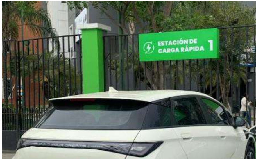
Foto 7.2. Estaciones de electrolinera.
