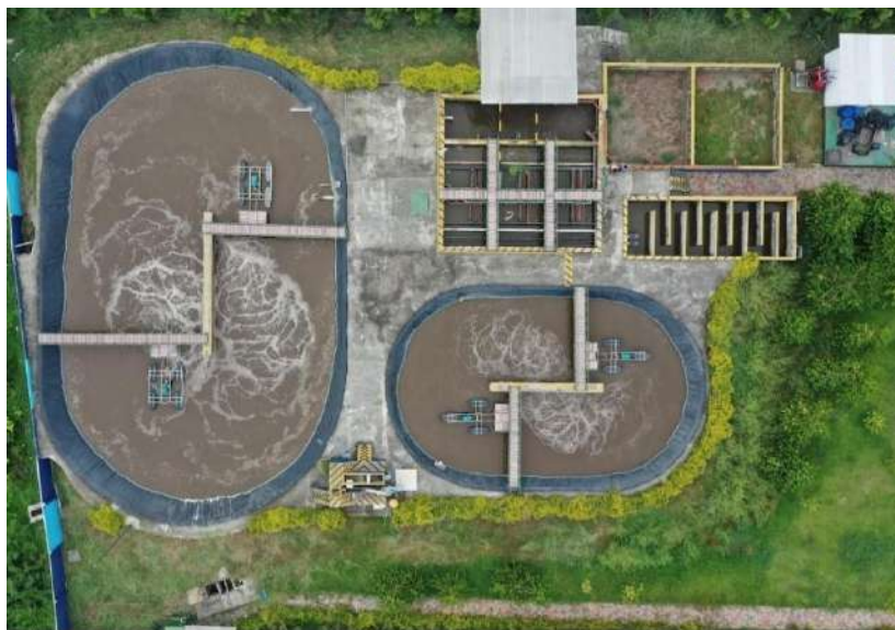
Foto 7.6. Planta de tratamiento de aguas residuales.
